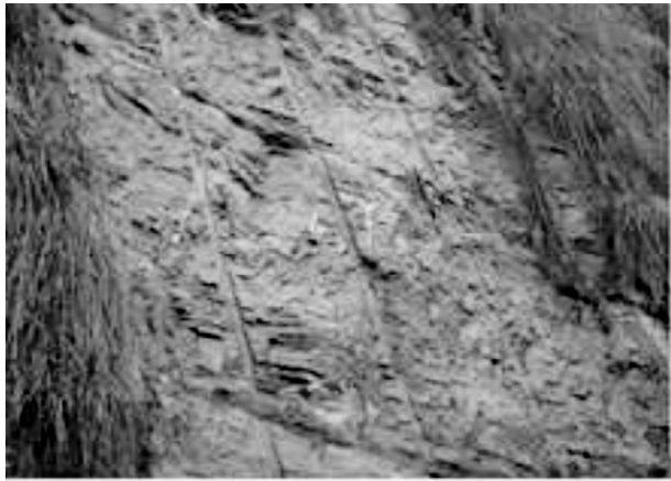
图 4 某高陡岩石边(斜)坡绿化 6 a 后发生滑坡
