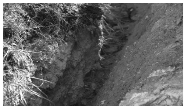
图2 汶川县姜维城山体裂缝
