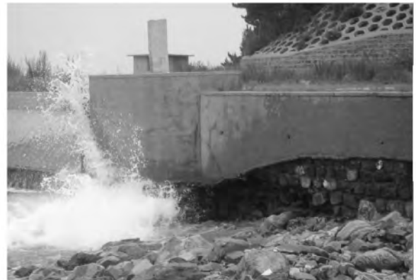
图7 大艾子口海岸护墙的侵蚀破坏
