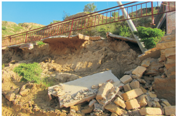
f 道路边坡坍塌
