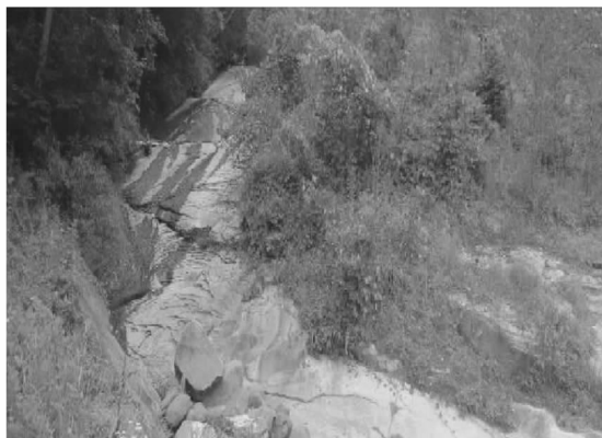
图 3 龙洞水滑坡右侧冲沟揭露的滑床
